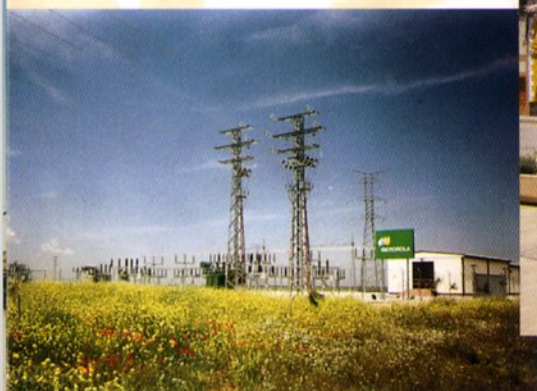
Nueva subestación eléctrica
