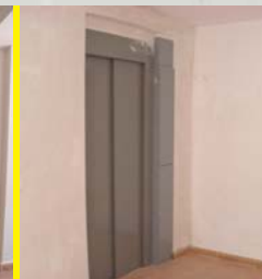
Ascensor edificio municipal en el polígono Torovizco
